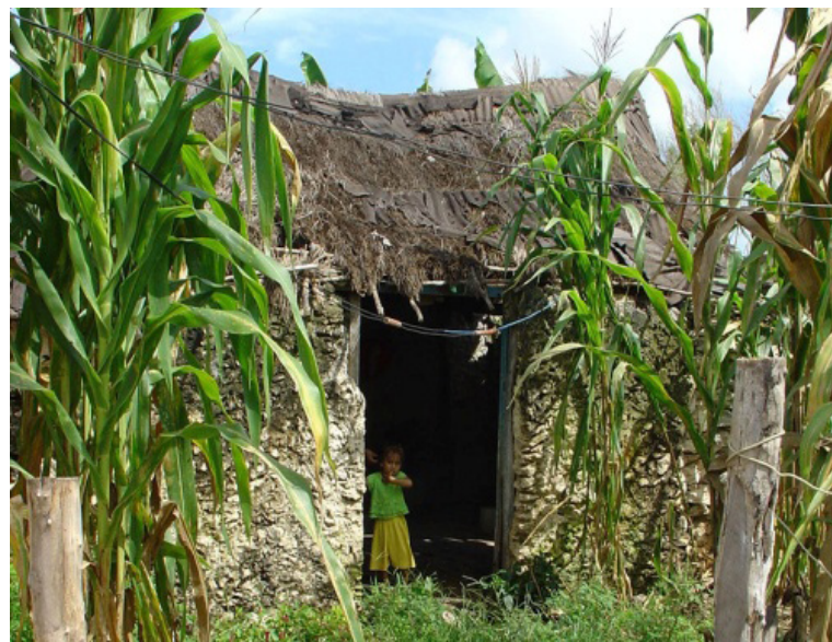
Figuras 4 y 5 Daños principalmente en la cubierta al paso de los huracanes en Dzidzantún, Yucatán. Fotografías: Isis Rodríguez Pérez. Catálogo Casas mayas en la costa de Yucatán.
