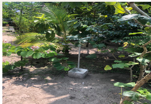
Imagen 37. Toma domiciliaria de agua
