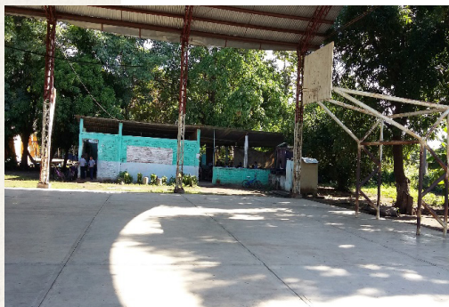
Imagen 52. Falta de mantenimiento de aulas
