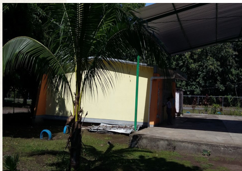
Imagen 58. Aulas con daños por sismo
