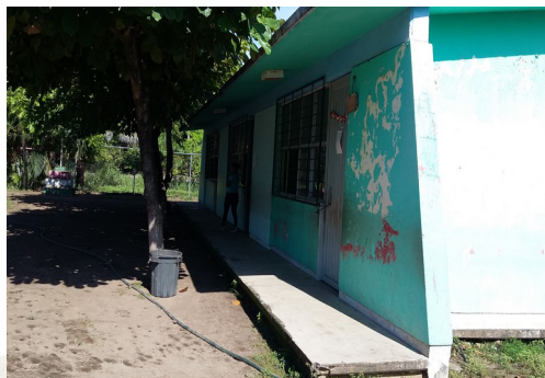
Imagen 53. Aula precaria, insegura
