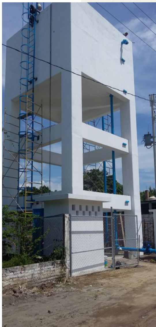
Imagen 35. Pozo profundo, tratamiento, tanque elevado y distribución de agua potable
